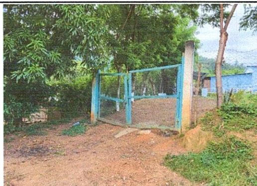
Foto 4: Evidencia la necesidad de mejoramiento del portón y puerta de acceso al establecimiento.
